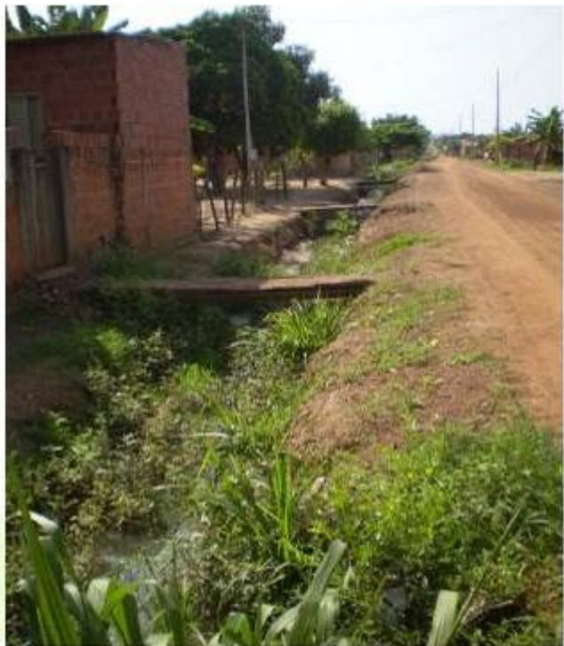
Figura 147. Drenagem de efluentes domésticos a céu aberto – Vila Érica, São Pedro da Cipa.
