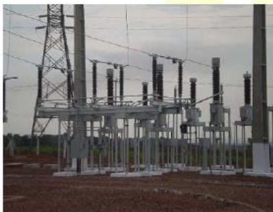
(a) Subestação retransmissora da PCH Foto: Seiva Engenharia e Projetos Ambientais
